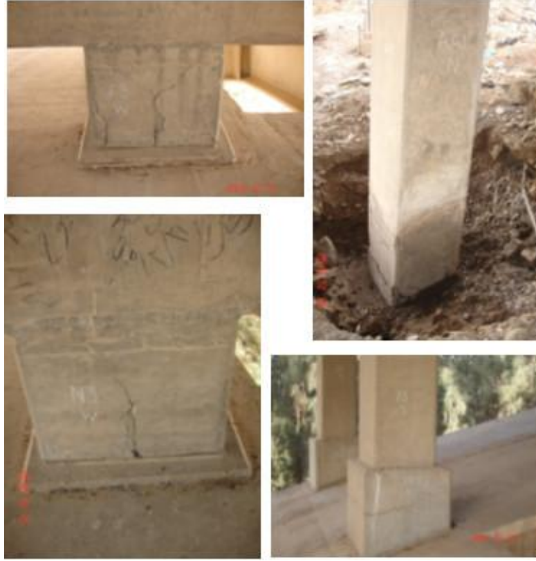
الصورة (٢): تضرر الأعمدة نتيجة للزحف الحاصل بالجسر.
