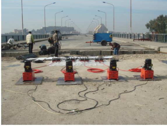
الصورة (٥): وربط الجكات بأربع مضخات هيدروليكية نوع HEP207312.
